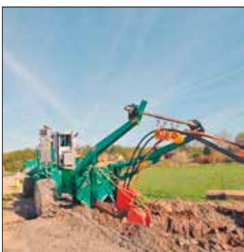
Foto: E-Weir, Bad Radkersburg
